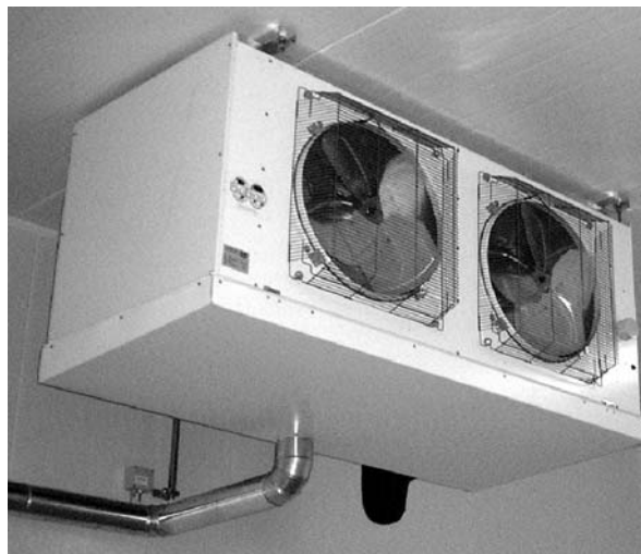
Photo 6 FRIGORIFÈRE REFROIDISSEUR D'AIR EN SALLE
